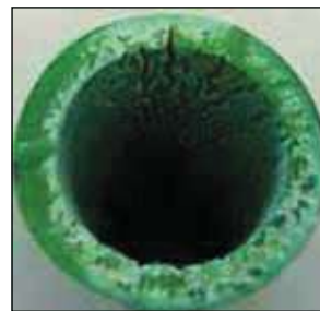
Ilustración 3.7 Daños observados con PP-R no estabilizado adecuadamente, bajo condiciones extremas
