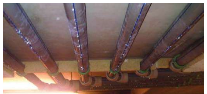
Ilustración 6.5 Condensación en tuberías de agua fría
