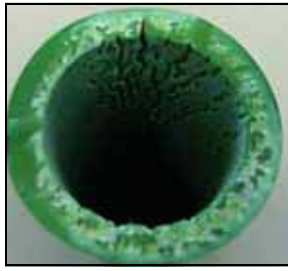
Ilustración 3.9 Daños observados con PPR no estabilizado adecuadamente, bajo condiciones extremas
