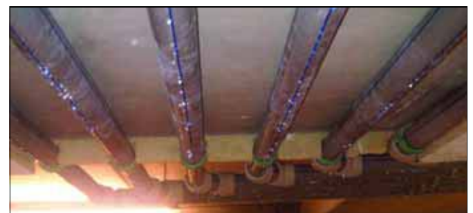
Ilustración 6.5 Condensación en tuberías de agua fría
